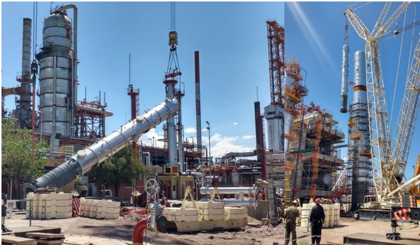
Stripper de Gasoil y Kerosen
